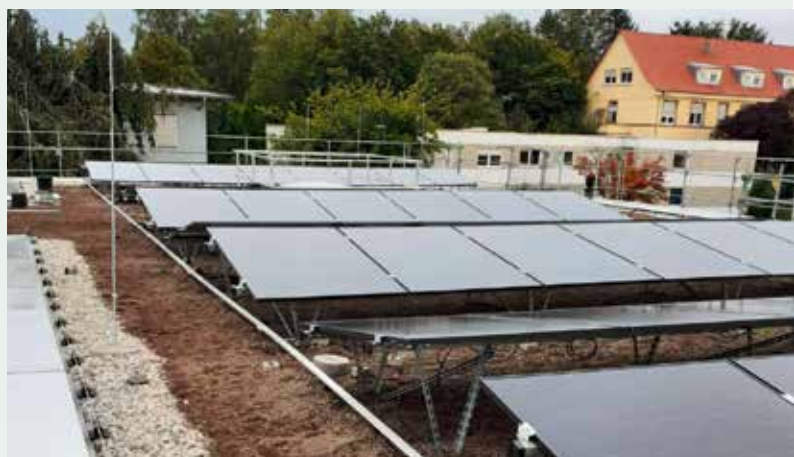
Die neue PV-Anlage
